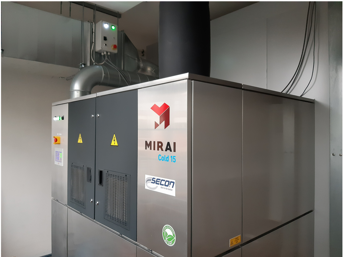
Die verwendete umweltschonende Kälteanlage, deren Technik auf dem Kaltluft-Prinzip basiert © Thomas Frank
